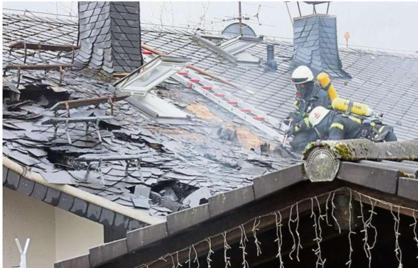
Mit der Rettungssäge öffneten die Einsatzkräfte das Dach, um an die Glutnester zu gelangen.
