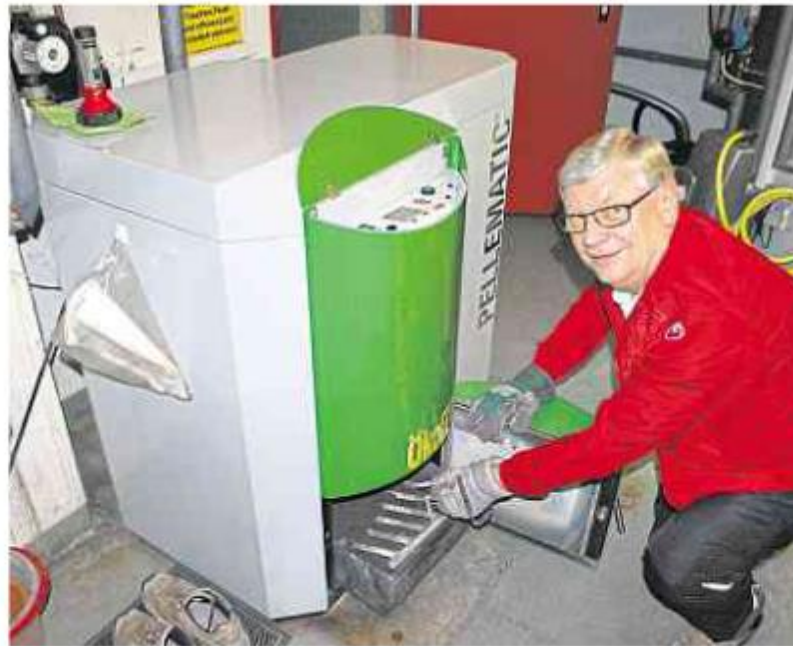
Die Pelletheizung von Dieter Ackermann läuft seit 2005 reibungslos. An der fast vollautomatisch arbeitenden Anlage muss lediglich im Abstand von einigen Wochen der Aschebehälter geleert werden.
